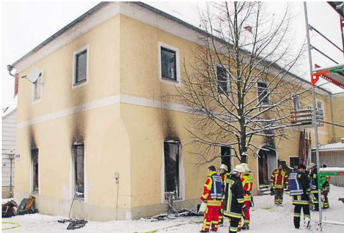
Das Erdgeschoss in dem Mehrfamilienwohnhaus Ecke Von-Hazzi-Straße/Osterriedergasse ist komplett ausgebrannt.
